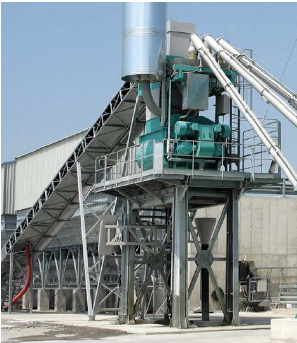
Gruppo di miscelazione ORULK 100-120-125-130 con nastro di carico e tramoggia di attesa inerti
