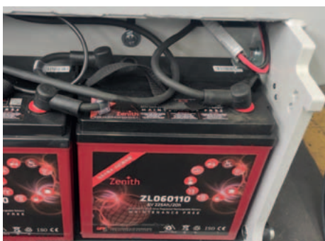
Vano batterie AGM
